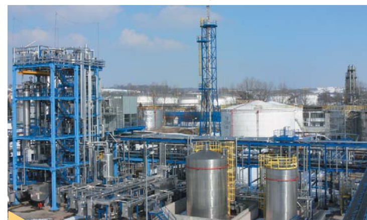
Instalacja hydrowyodróżnienia parafin w Rafinerii Trzebinia
